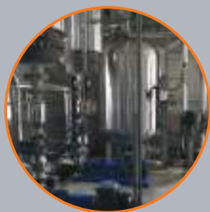
Резервуар Process Tank
